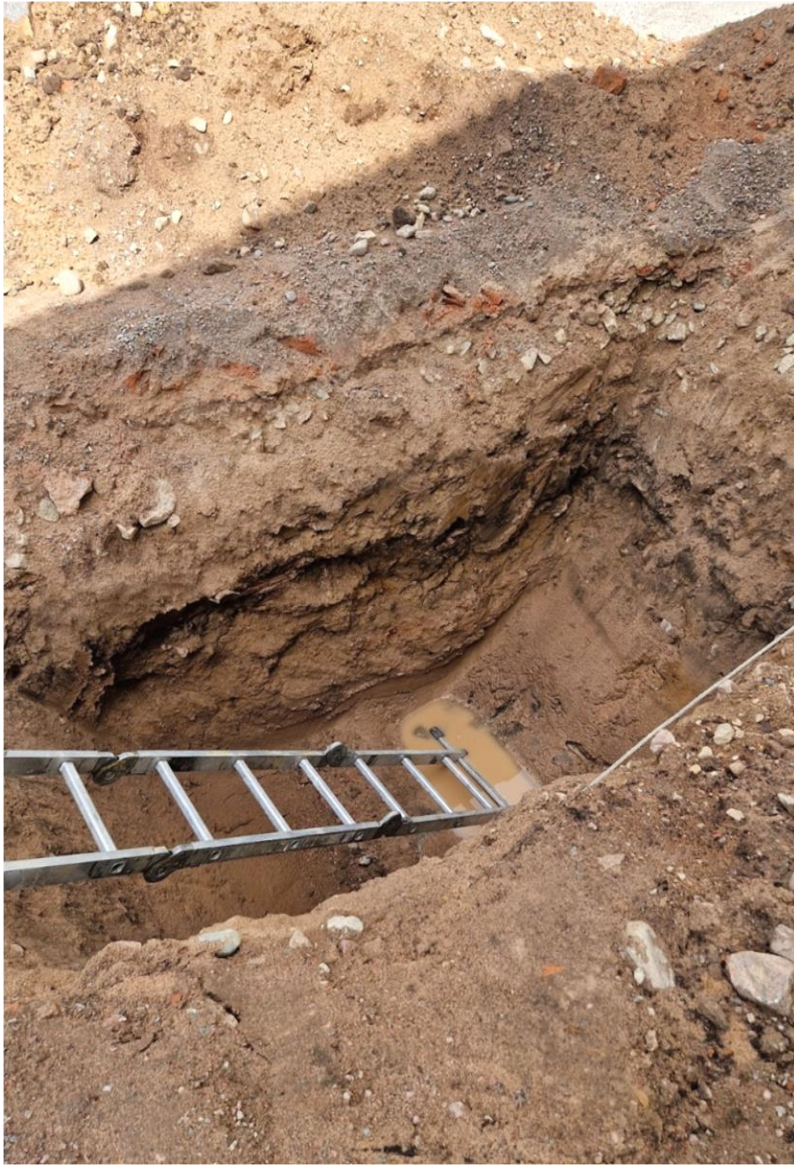
Bild 1: Provpunkt 1. Det är inte grundvatten utan regnvatten som syns i schaktet.
