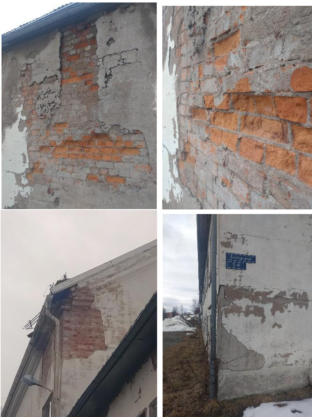
Bilder skadad puts på fasad samt grund.
