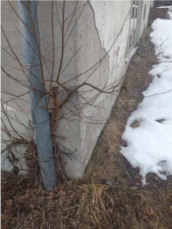
Putsskador i grund.
