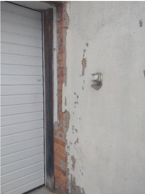
Putsskador i fasad.
