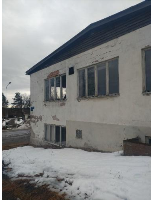
Fasad med putsskador.
