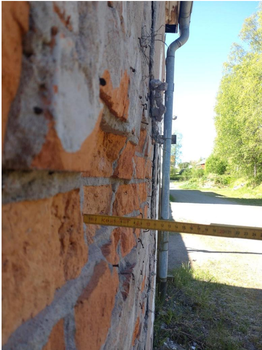
Skadat puts och tegel i fasad.
