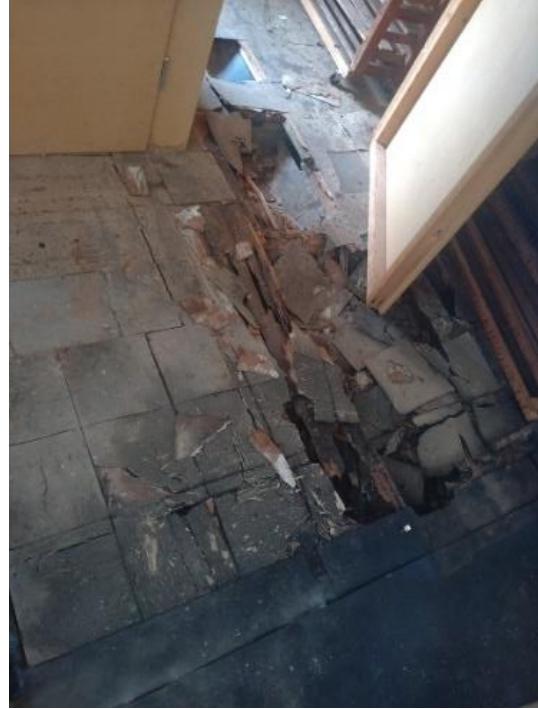
Fuktskadat golv och bjälklag plan 3.
