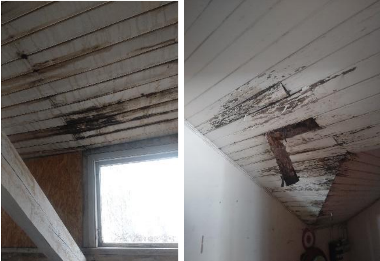
Fuktskador genom yttertak plan 3.
